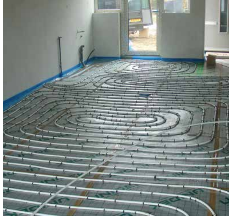
Schouten, Niederlande ▲ Fußbodenheizung
