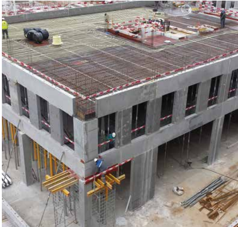
▲ Post X, Antwerpen, Belgien Betonkernaktivierung
