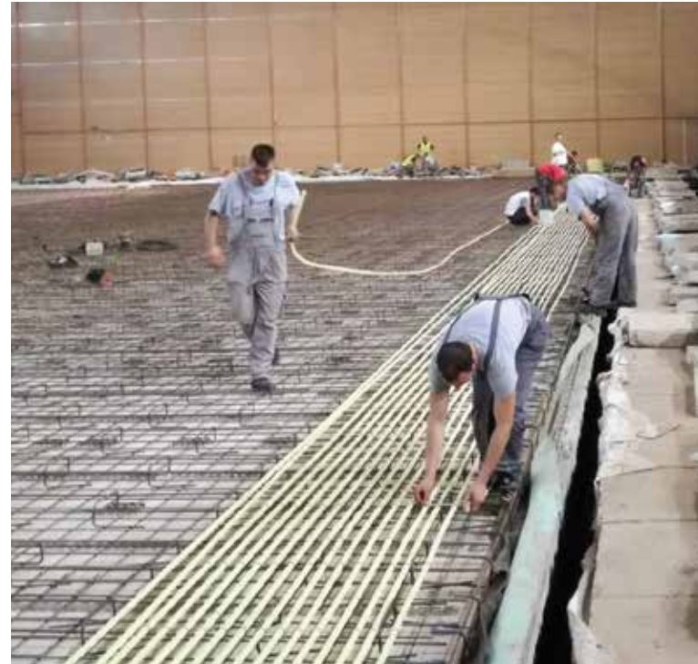
▲ Rink Stadium, Zagreb, Kroatien System für Kühlung Eisbahn
