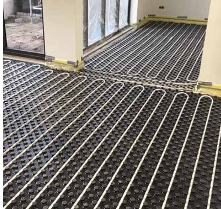
Breda Niederlande ▲ Fußbodenheizung
