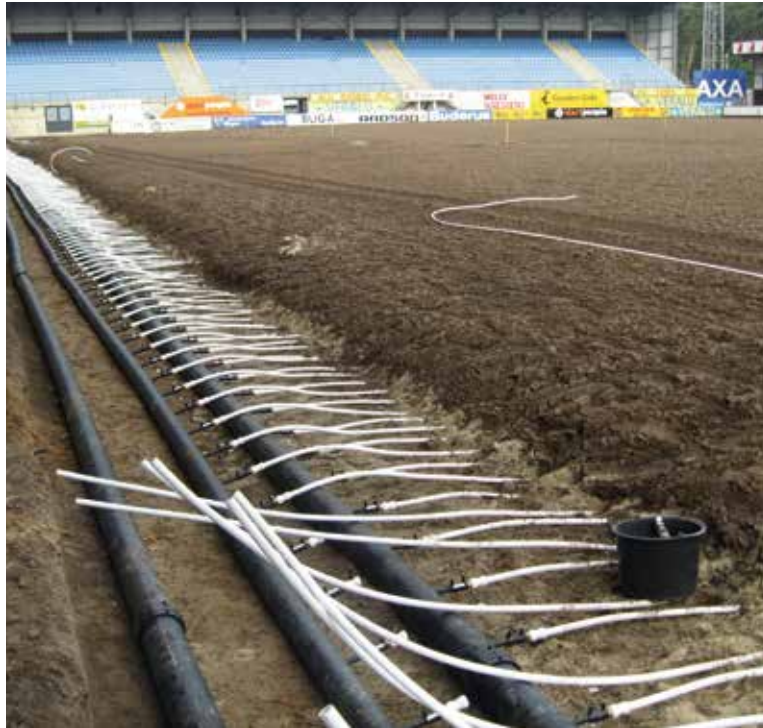
▲ Fußballstadium, Westerlo, Belgien Fußballfeldheizung
