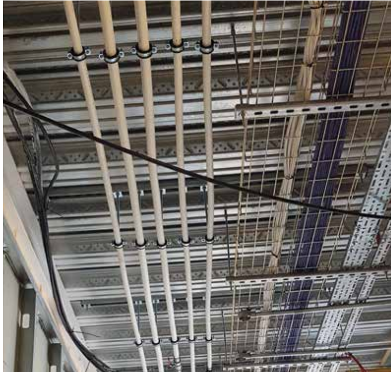
▲ Chichester University, VK Heizung und Sanitär
