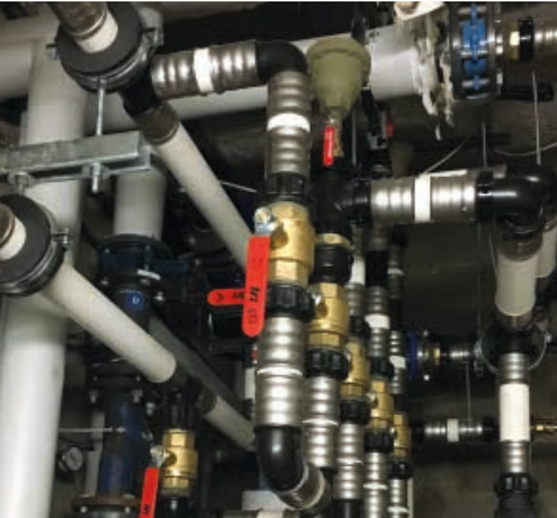
▲ Ayuntamiento de Villeneuve-lès-Avignon, Francia Instalación de Henco Vision para fontanería
