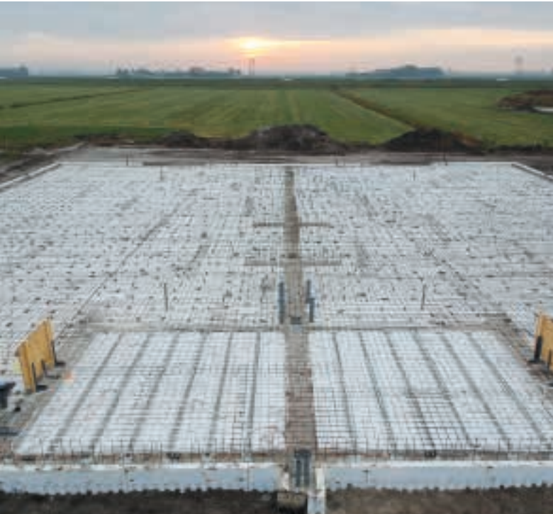
▲ Proyecto Lemmer, Friesland, Países Bajos Suelo Radiante
