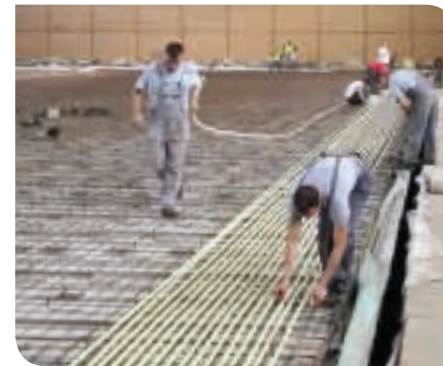
Croacia - Instalacion de refrigeracion
