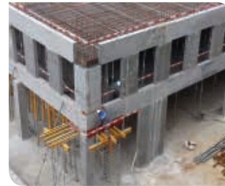
Belgica - Suelo Radiante viviendas
