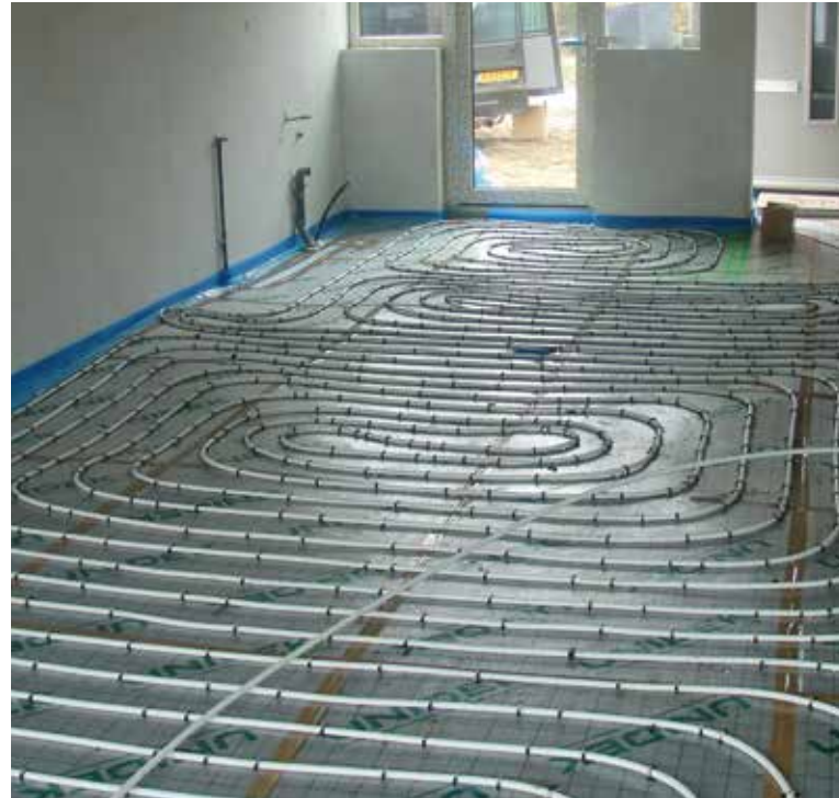
Schouten, Nederländerna ▲ Golvvärme
