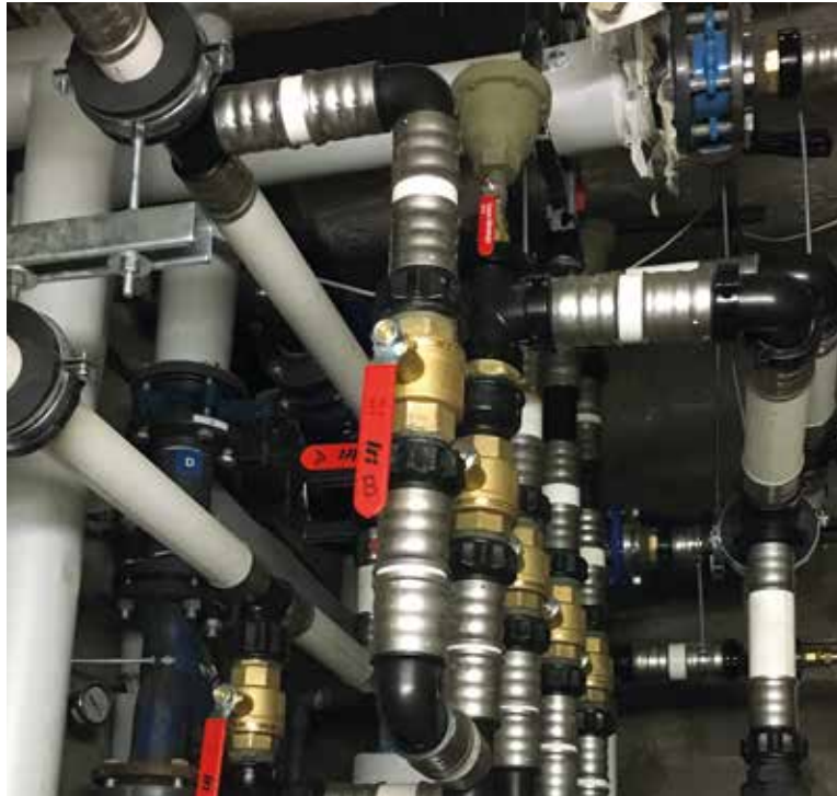
▲ Mairie de Villeneuve-lès-Avignon, Frankrike PVDF super size för sanitärt
