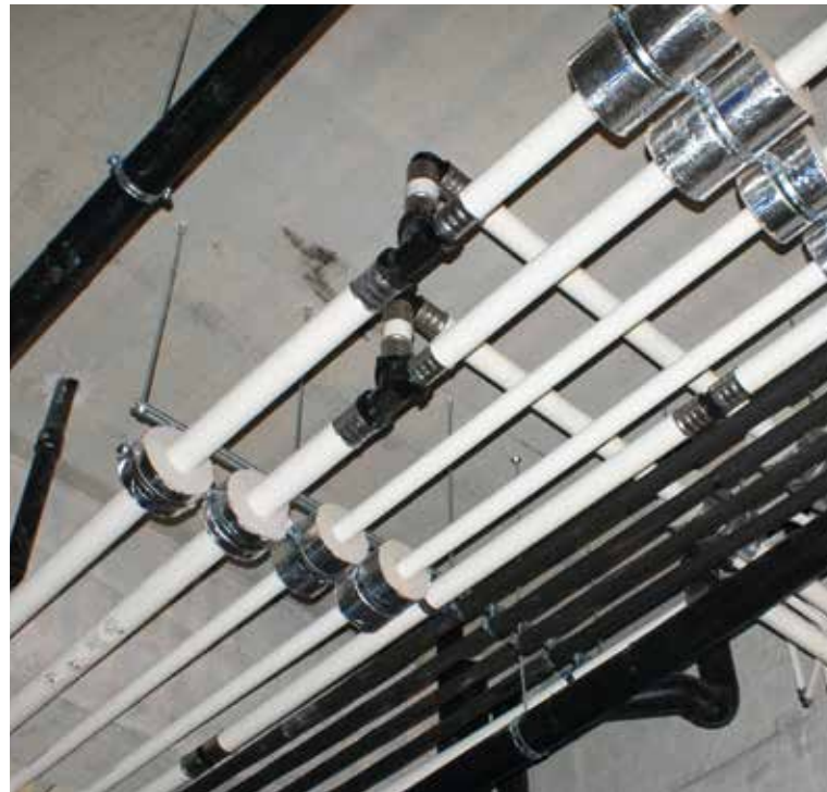
Fotbollsstadion, Sydafrika ▲ PVDF-presskopplingar för sanitär
