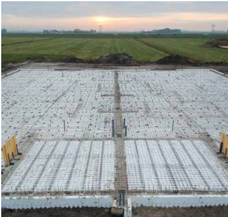
▲ Projekt Lemmer, Friesland, Nederländerna Golvvärme
