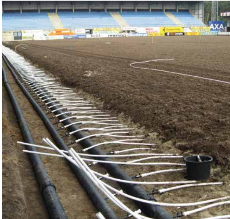
▲ Fotbollsstadion, Westerlo, Belgien Uppvärmning av fotbollsplaner
