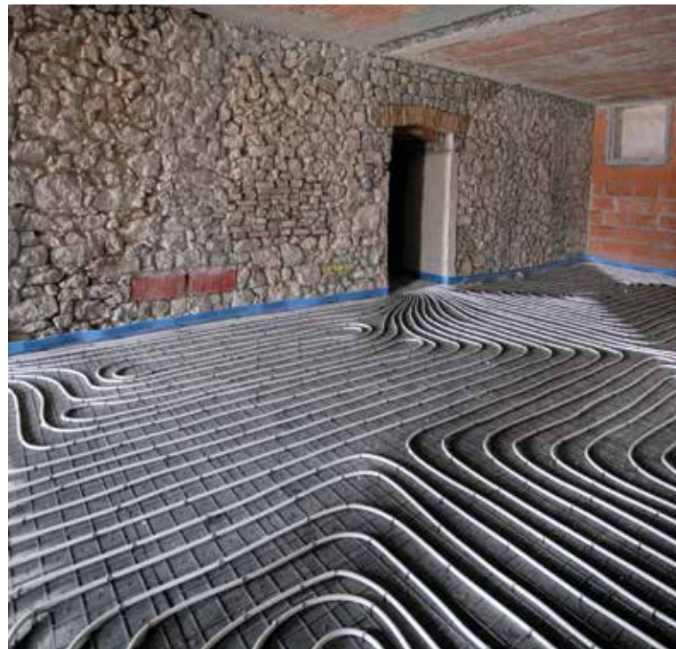
Château, Italie ▲ Chauffage par le sol
