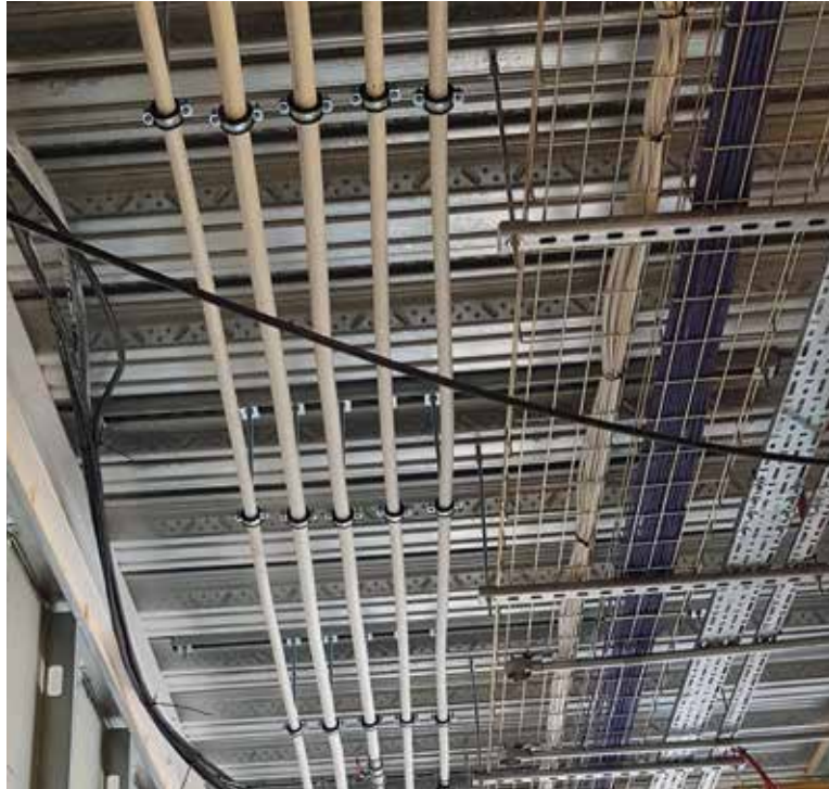
▲ Chichester University, Angleterre Chauffage et sanitaire
