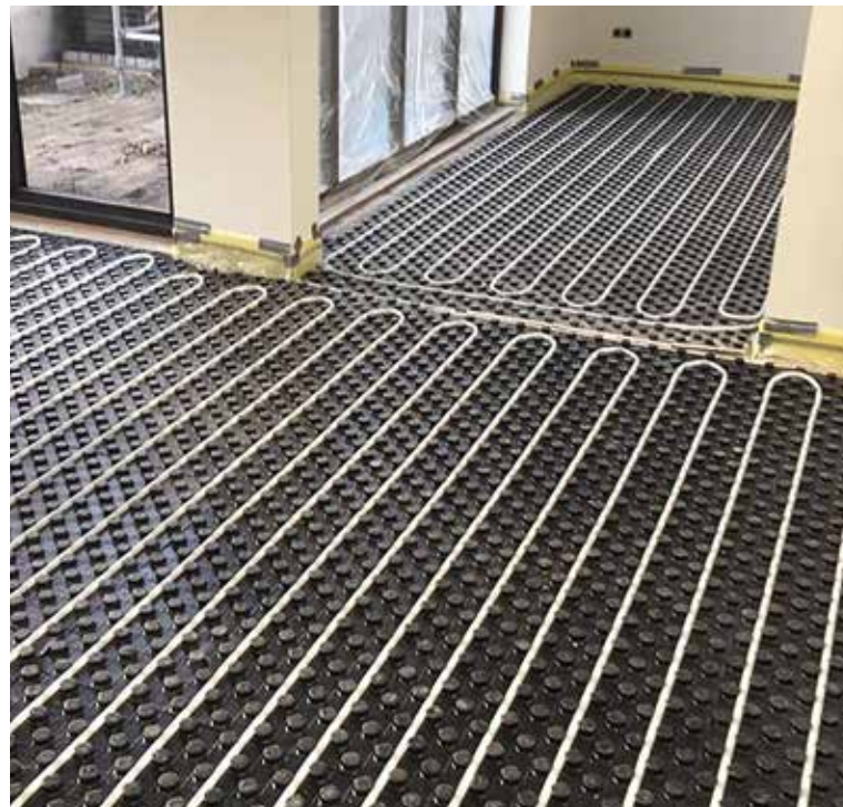
Breda Pays-Bas ▲ Chauffage par le sol
