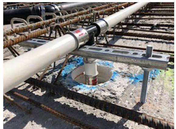
50P sprinklercup toegepast bij breedplaten (niet mee ingestort)
