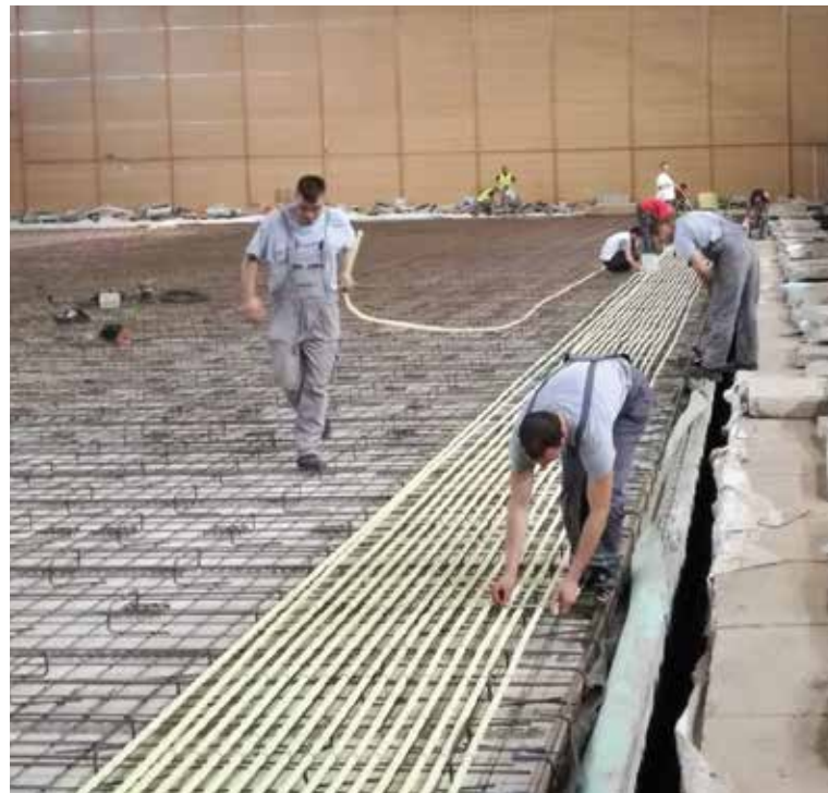
Rink Stadium, Zagreb, Kroatië ▲ Koelingsysteem voor indoor schaatsbaan
