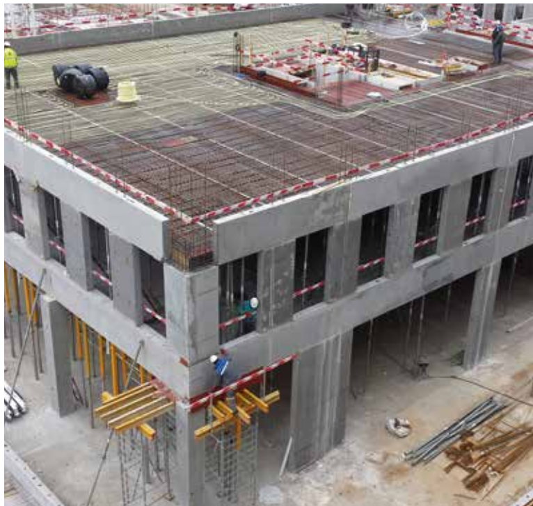
▲ Post X, Antwerpen, België. Betonkernactivering
