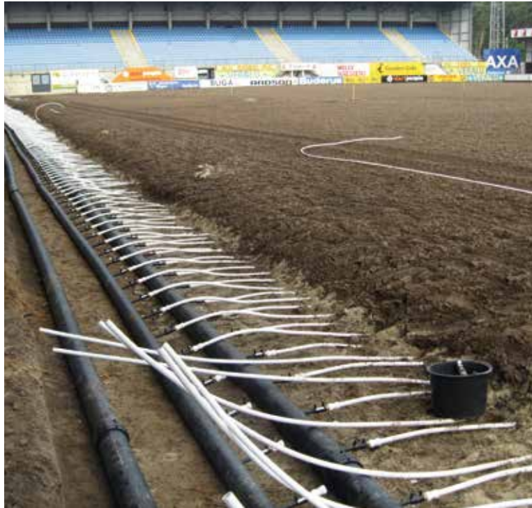
▲ Voetbalstadium, Westerlo, België Voetbalveldverwarming
